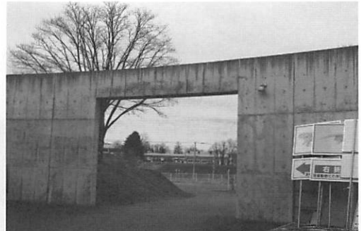
写真2. 大型トラックが通行できない通用口
